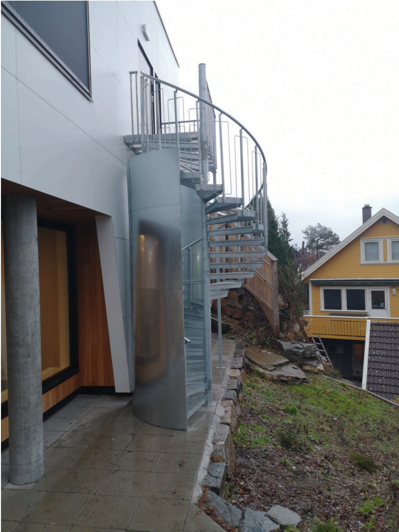
Spiraltrapp med varmeskjold
